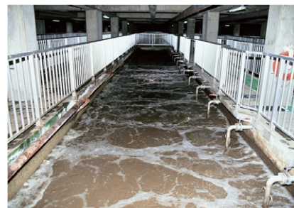
排水のばっき処理施設
