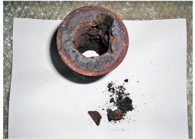
鉄による配管スケール障害
