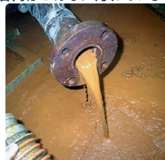
配管内はこんなに汚れています!
